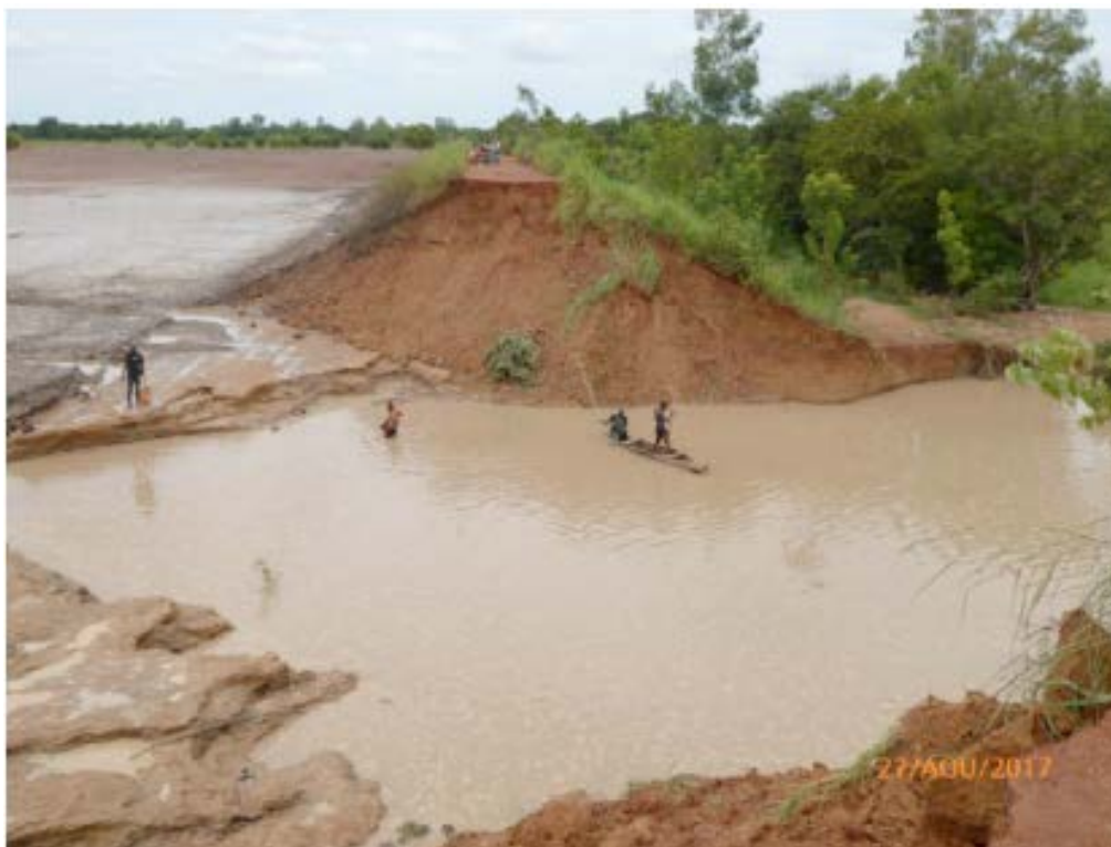
Figure 18 : Rupture d'une digue à Koubri après une grosse pluie en août 2017 (Source : Ouédraogo, 2017)
