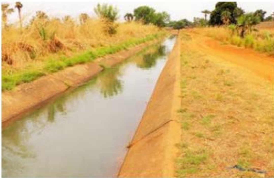
Figure 14 : Exemple de canalisation au Burkina Faso (Source : Kaboré, 2016)
